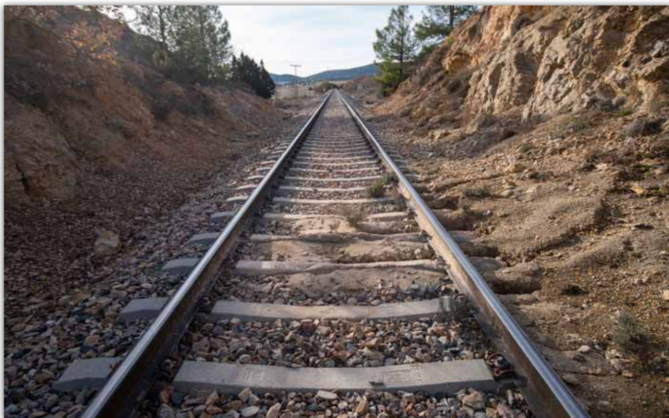
Antonio García-Bykofoto. Erosión de talud de desmonte. Tierras deslizadas hasta la superestructuras. Vegetación y arrastres en la propia superestructura.
