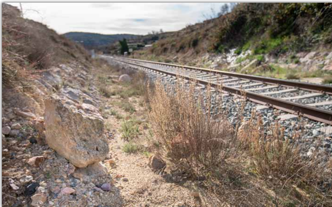
Antonio García-Bykofoto. Existencia de rocas en el talud de desmonte con peligro de desprendimiento (algunas rocas han llegado a la cuneta)
