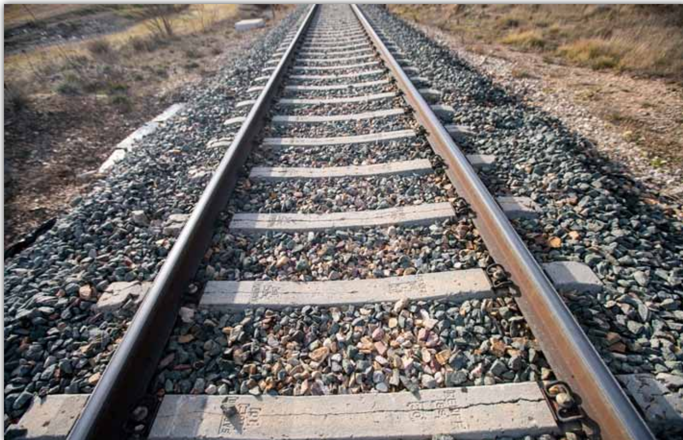
Antonio García-Bykofoto. Traviesas monobloc deterioradas. Partidas longitudinalmente.
