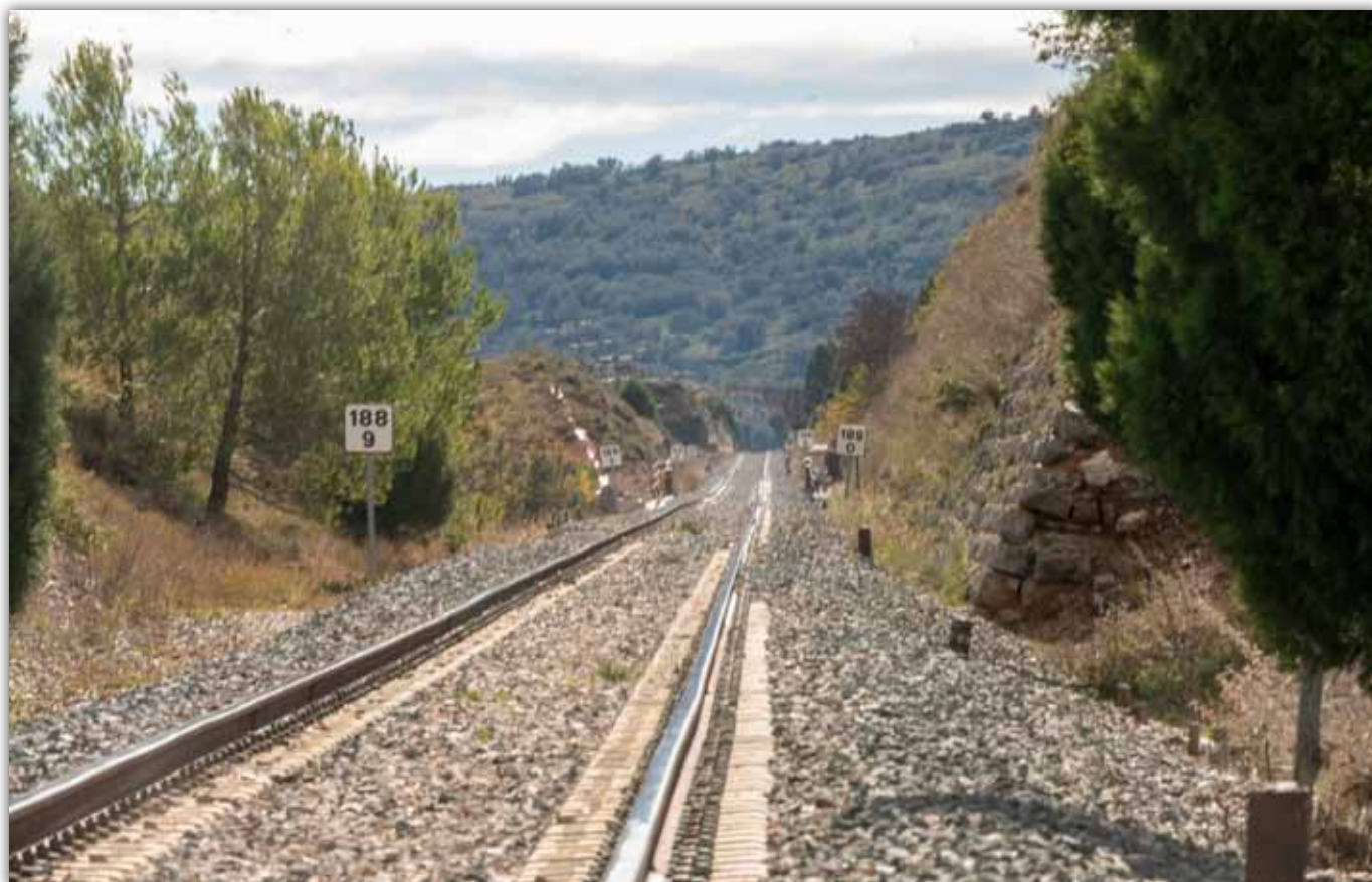
Antonio García-Bykofoto. Superestructura con carriles mal perfilados.
