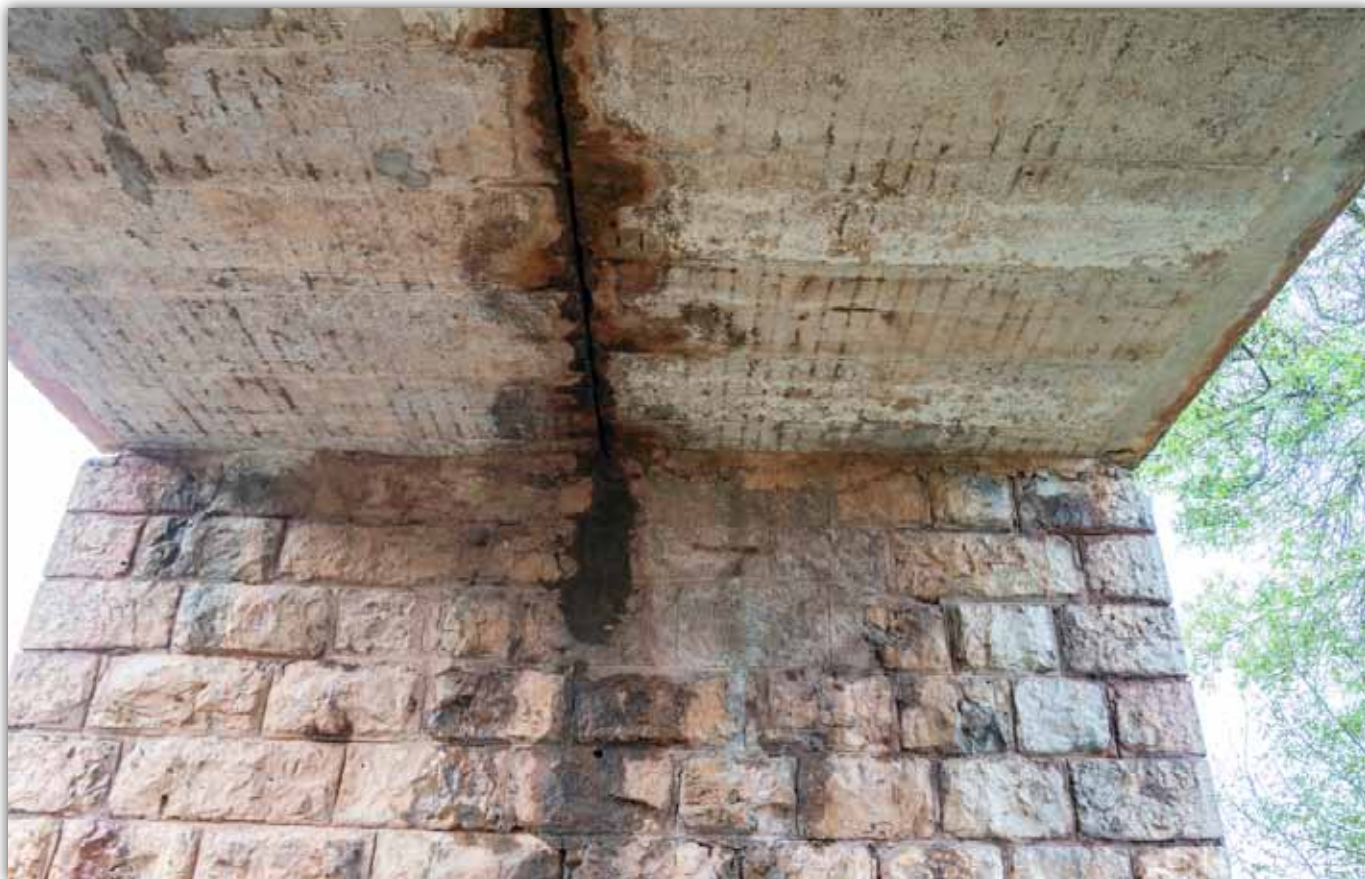
Antonio García-Bykofoto. Armaduras oxidadas y sin revestimiento.
