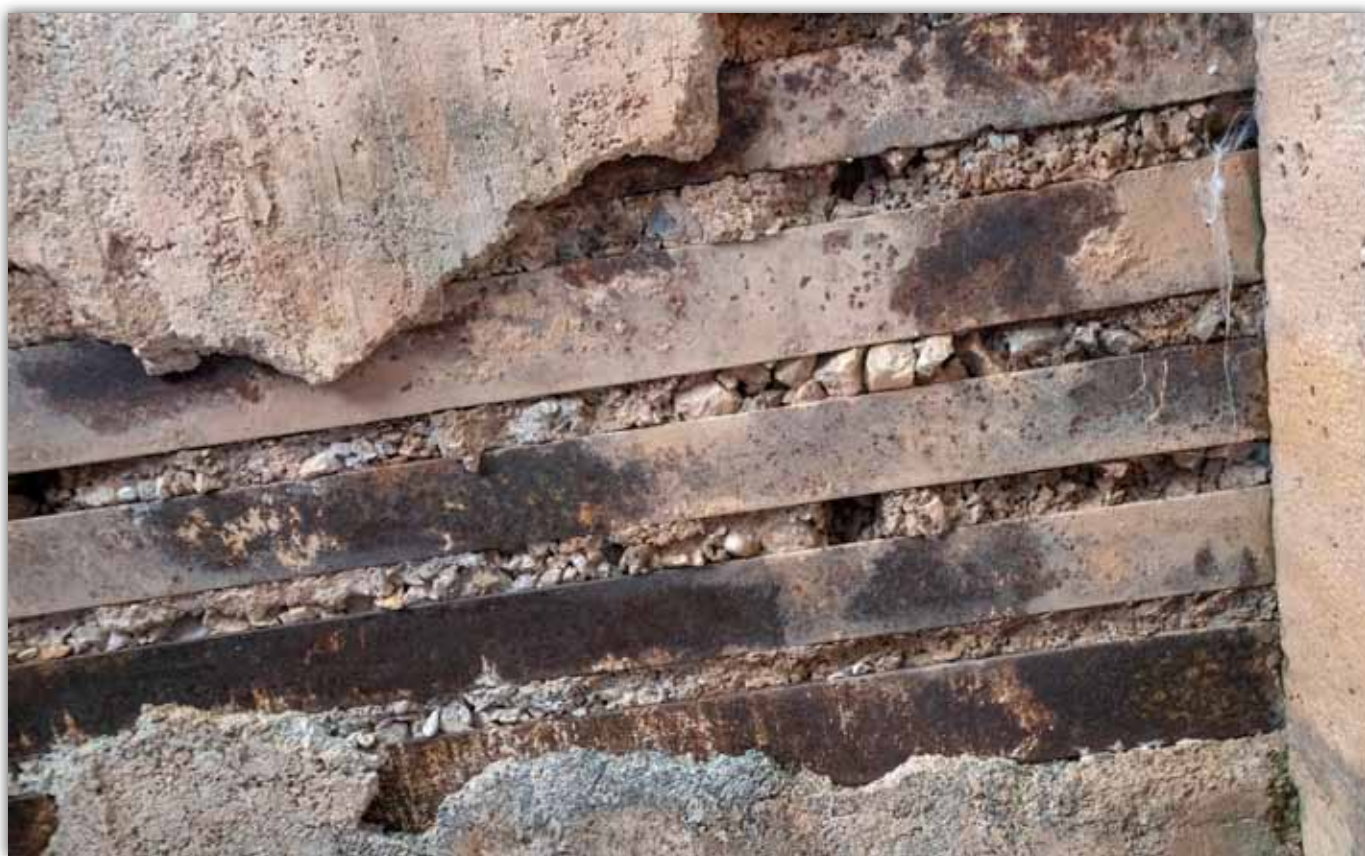
Antonio García-Bykofoto. Pérdida de recubrimiento de elementos metálicos de la estructura con caída de balasto.
