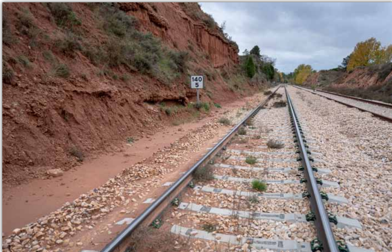
Antonio García-Bykofoto. Balasto contaminado con tierra y barro.
