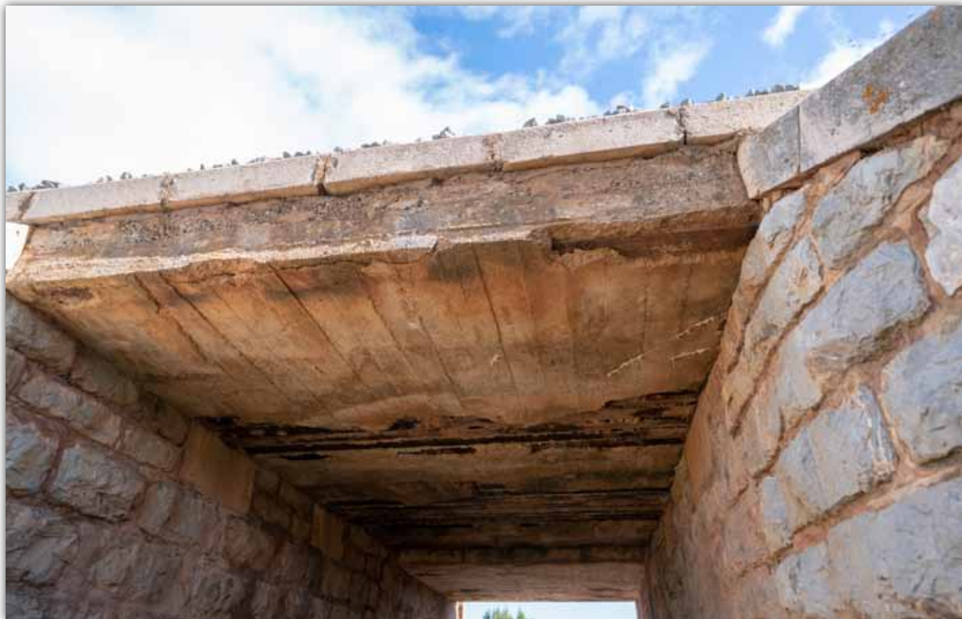
Antonio García-Bykofoto. Pérdida de recubrimiento de la estructura. Oxidación generalizada de los elementos metálicos.
