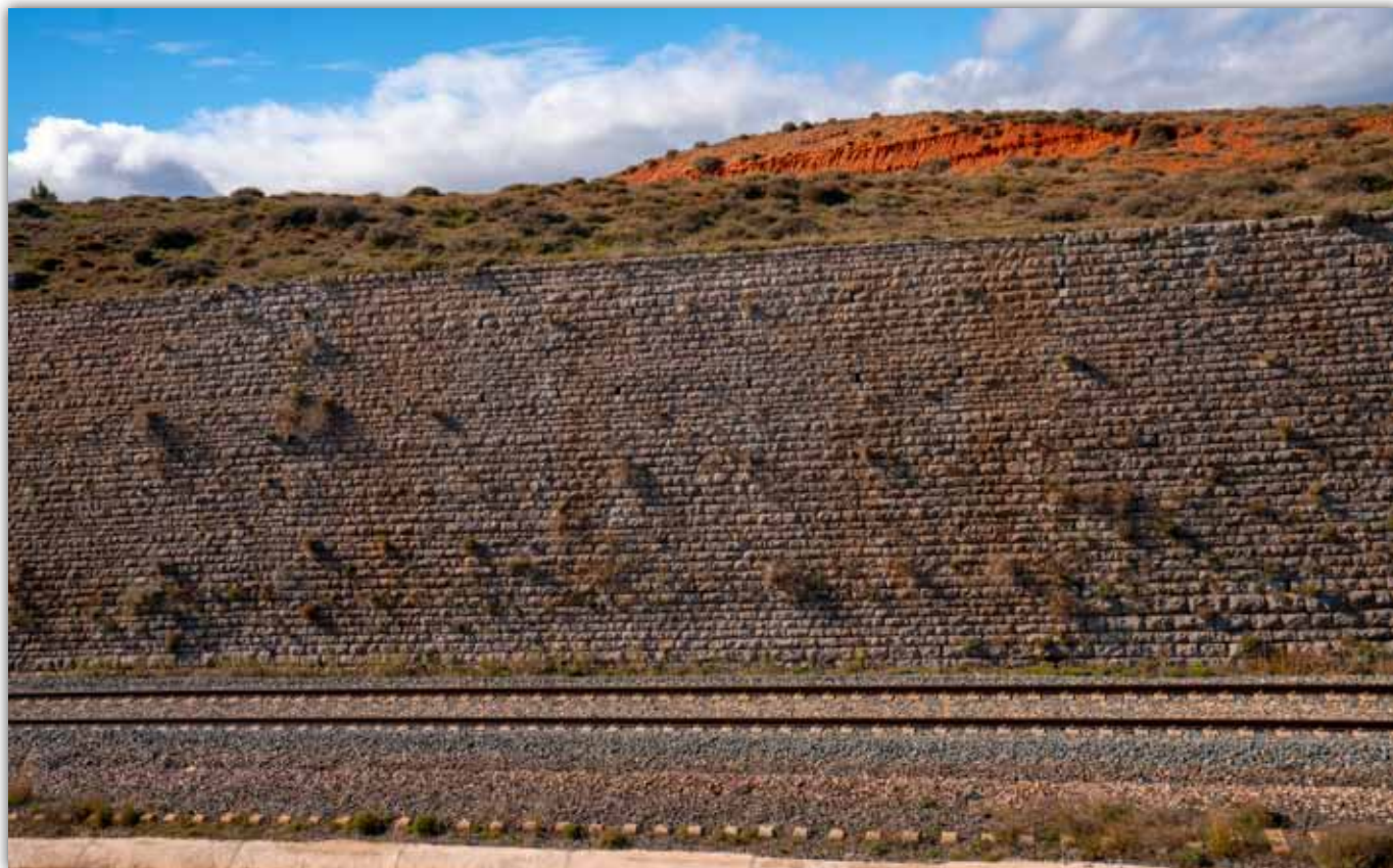
Antonio García-Bykofoto. Pared de revestimiento de mampostería/sillería en la que se observan grietas y crecimiento de vegetación. Asimismo se observan restos de arcilla depositados por la caída de agua.
