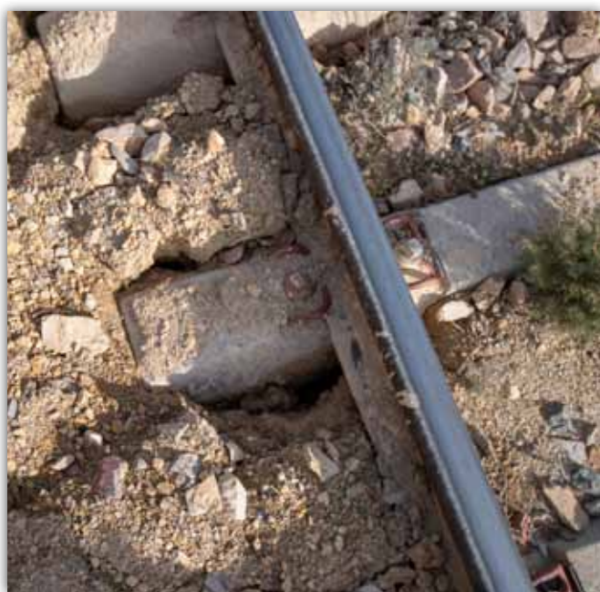
Antonio García-Bykofoto. Traviesa deteriorada.
