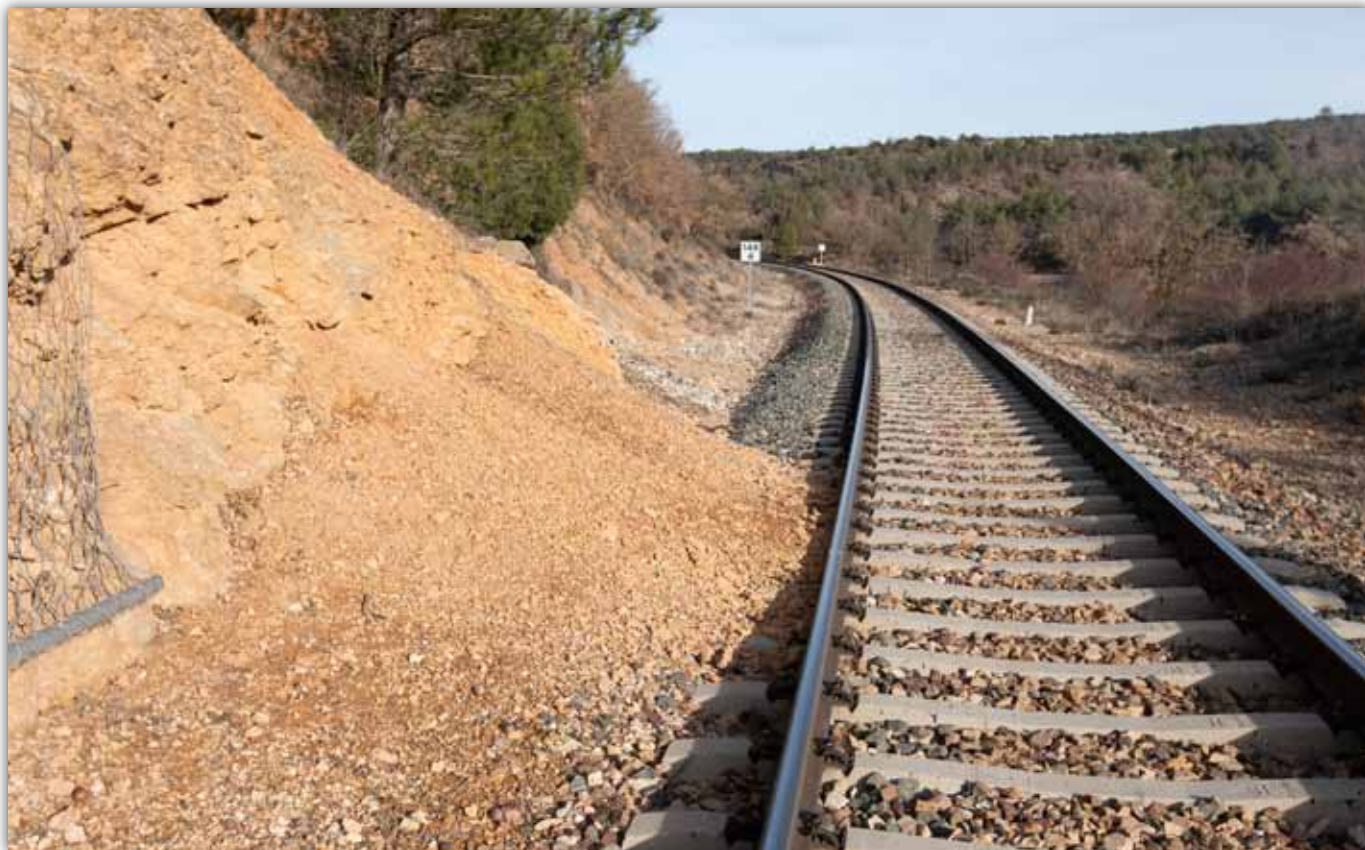
Antonio García-Bykofoto. Deslizamiento de tierras del talud que llega hasta la superestructura.
